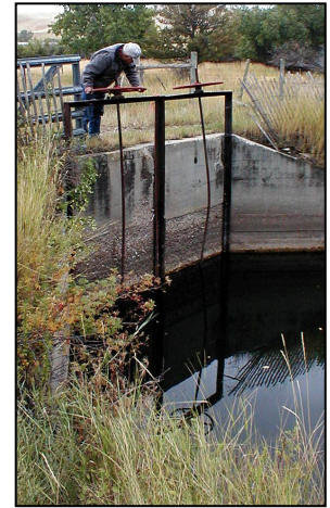
Leiter Ditch Headgate
